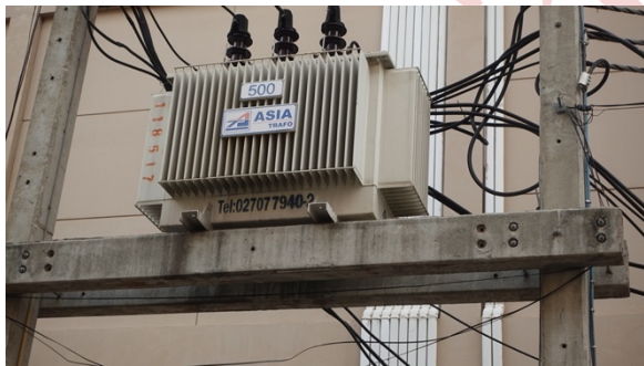
การตรวจสอบหม้อแปลง TR-2 ขนาด 500 kVA
