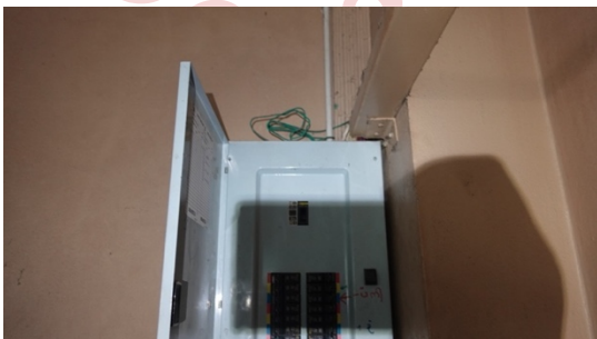
ลักษณะการติดตั้งตู้ย่อย LP-3
