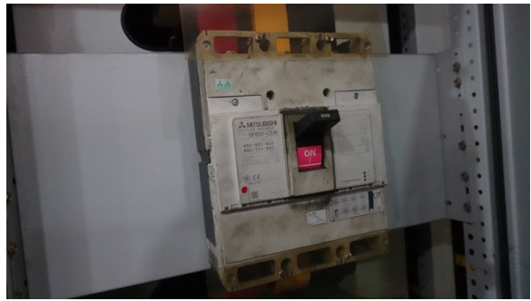
ตรวจสอบเมนเบรกเกอร์
