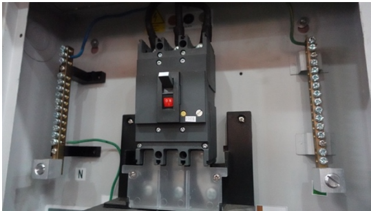
ลักษณะการติดตั้งตู้ย่อย LP-10
