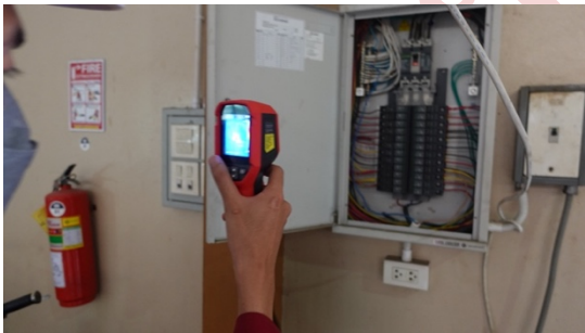
ลักษณะการติดตั้งตู้ย่อย LP-12
