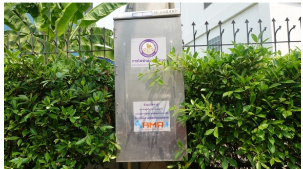
ตรวจสอบมิเตอร์และบันทึกผล
