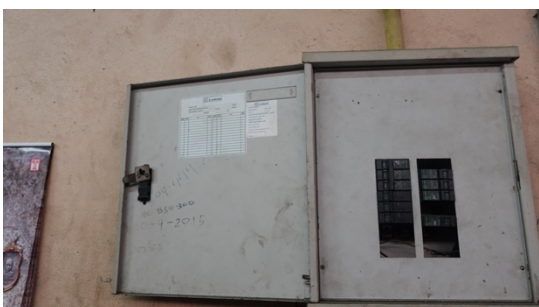
ลักษณะการติดตั้งตู้ย่อย LP-8
