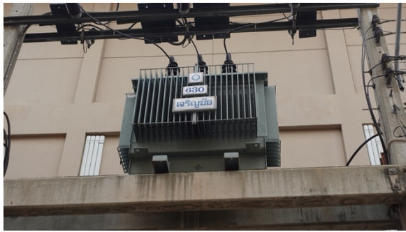
การตรวจสอบหม้อแปลง TR-1 ขนาด 630 kVA
