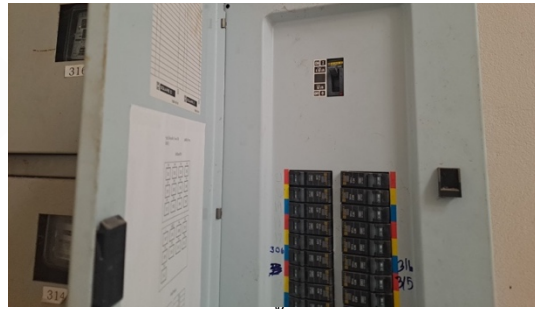
ลักษณะการติดตั้งตู้ย่อย LP-15
