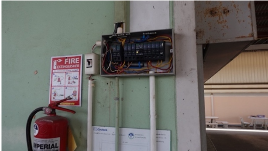
ลักษณะการติดตั้งตู้ย่อย Consume
