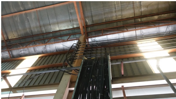
การเดินสายแรงต่ำผ่านรางเคเบิล (cable ladder) MDB-3
