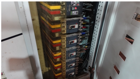
ตรวจสอบเบรกเกอร์ย่อย
