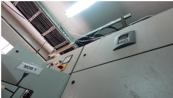
การเดินสายแรงต่ำผ่านรางเคเบิล (cable ladder) MDB-1
