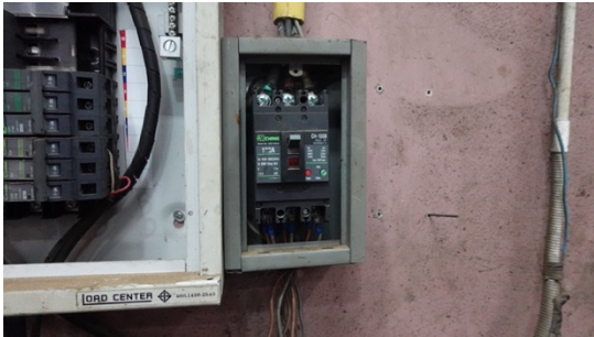
ลักษณะการติดตั้งตู้ย่อย LP-11
