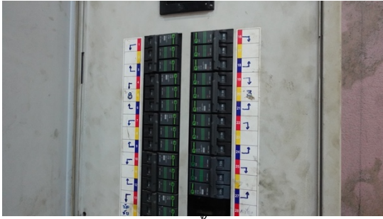
ลักษณะการติดตั้งตู้ย่อย LP-9
