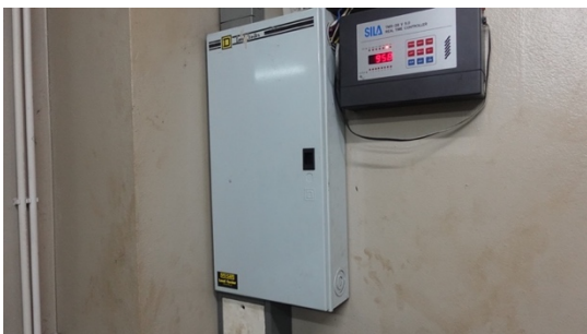
ลักษณะการติดตั้งตู้ย่อย LP-2
