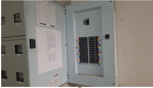
ลักษณะการติดตั้งตู้ย่อย LP-14
