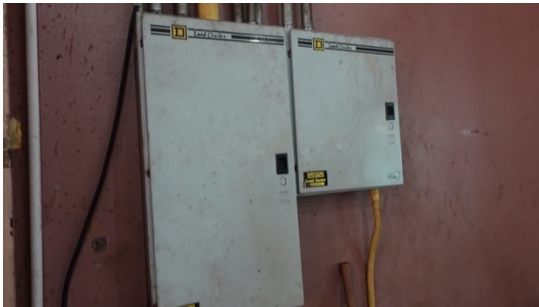
ลักษณะการติดตั้งตู้ย่อย LP-5
