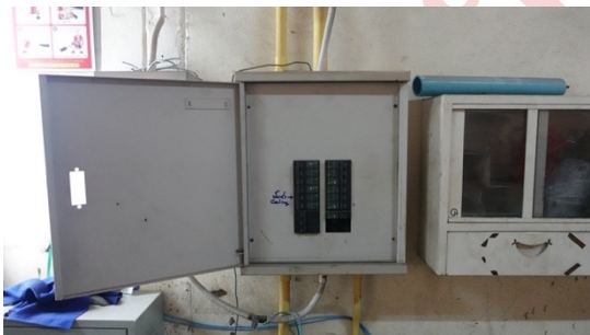
ลักษณะการติดตั้งตู้ย่อย LP-7
