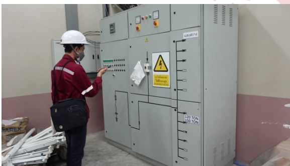
ลักษณะการติดตั้งตู้ MDB-2
