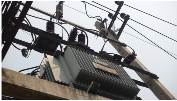
การตรวจสอบหม้อแปลง TR-3 ขนาด 315 kVA
