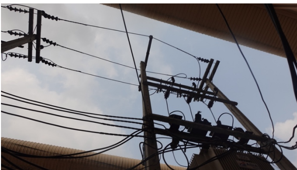
ลักษณะการเดินสายไฟภายในโรงงาน
