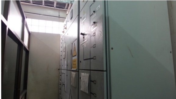
ลักษณะการติดตั้งตู้ MDB-1
