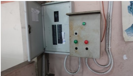
ลักษณะการติดตั้งตู้ย่อย LP-13
