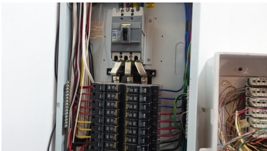
ลักษณะการติดตั้งตู้ย่อย LP-1
