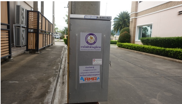
ตรวจสอบมิเตอร์และบันทึกผล
