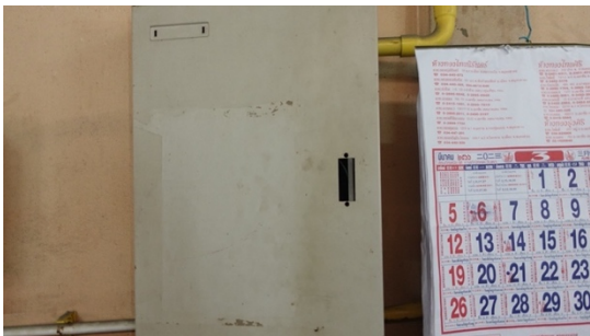
ลักษณะการติดตั้งตู้ย่อย LP-6
