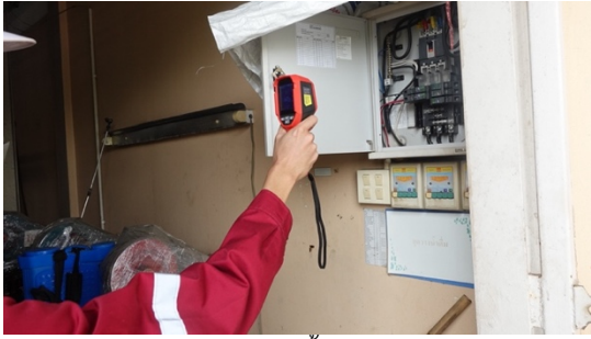
ลักษณะการติดตั้งตู้ย่อย LP-4
