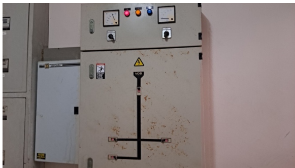
ลักษณะการติดตั้งตู้ MDB-4
