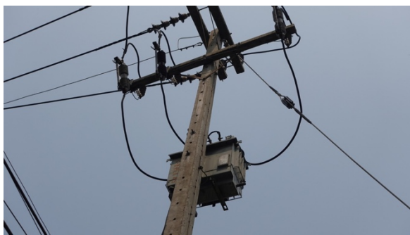
การตรวจสอบหม้อแปลง TR-4 ขนาด 50 kVA
