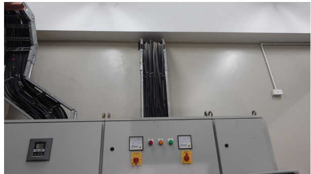
การเดินสายแรงต่ำผ่านรางเคเบิล (cable ladder) MDB-2
