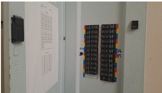
ลักษณะการติดตั้งตู้ย่อย LP-16
