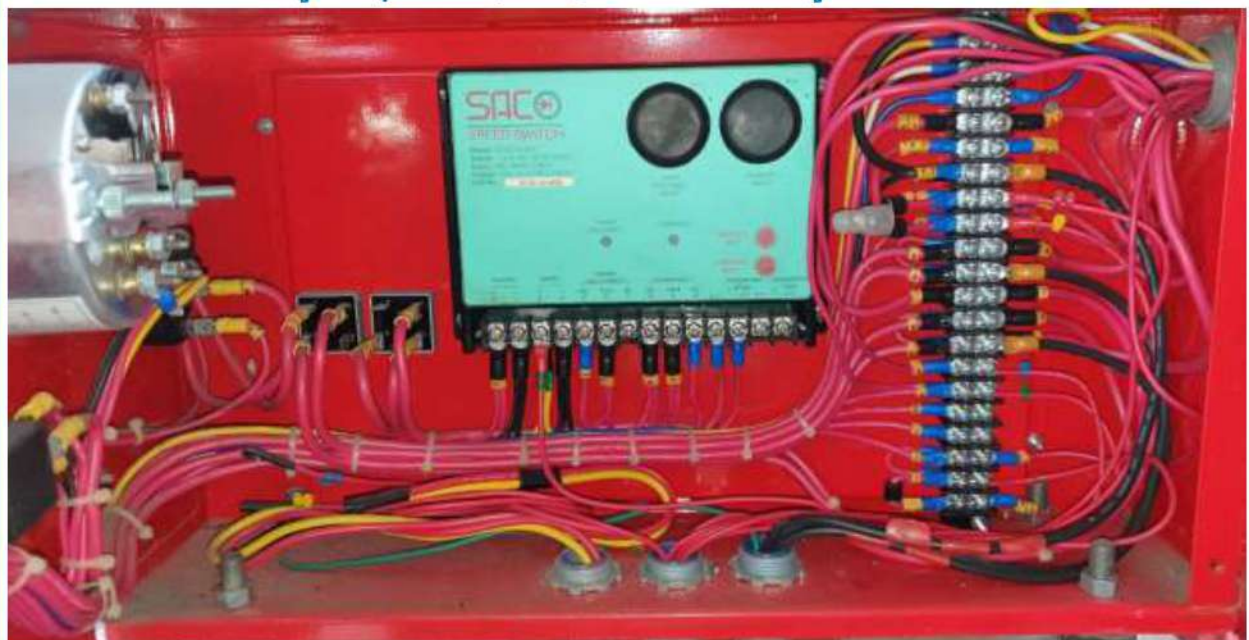
ตู้ควบคุม Fire Pump ที่ตัวเครื่องยนต์ การเดินสายไฟอยู่ในสภาพปกติ
