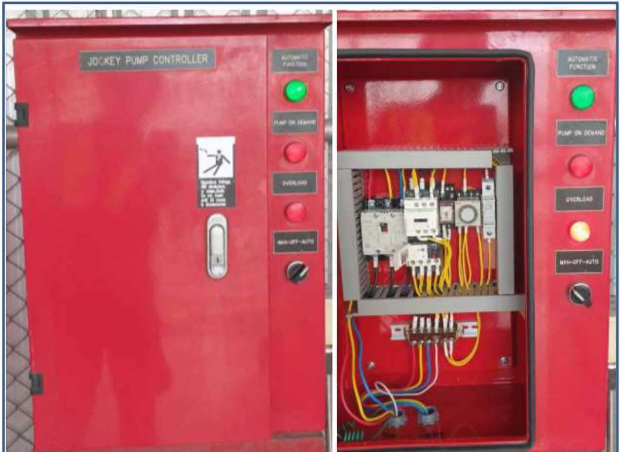
ตู้ควบคุม Jockey Pump การเดินสายไฟอยู่ในสภาพปกติ
