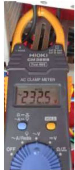
ค่าแรงดันไฟฟ้า R-N
