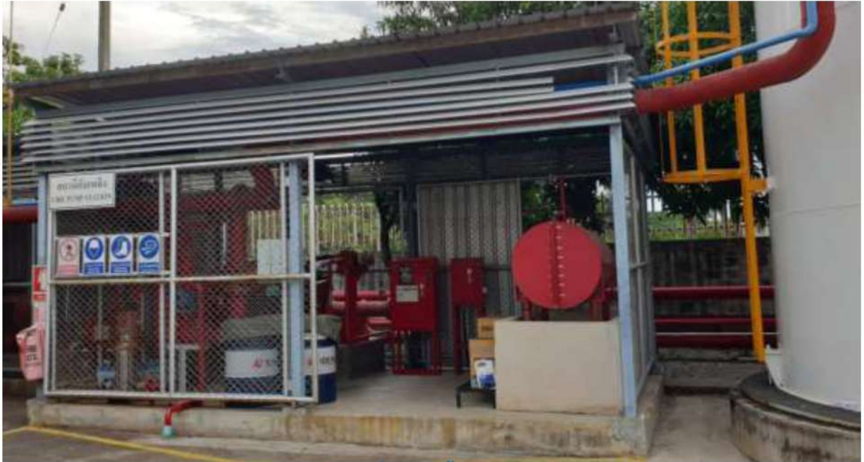
ห้องเครื่องสูบน้ำดับเพลิง
