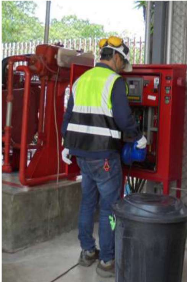
ทำความสะอาดห้องเครื่องและอุปกรณ์ต่างๆ
