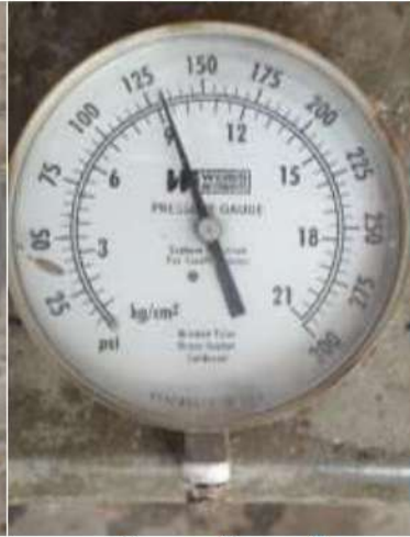
เกจวัดความดันทางด้าน จ่ายของปั้มน้ำดับเพลิง
