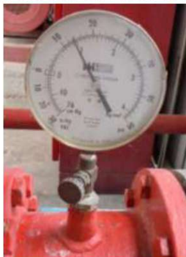
แรงดันน้ำด้านดูด=13.5PSI
