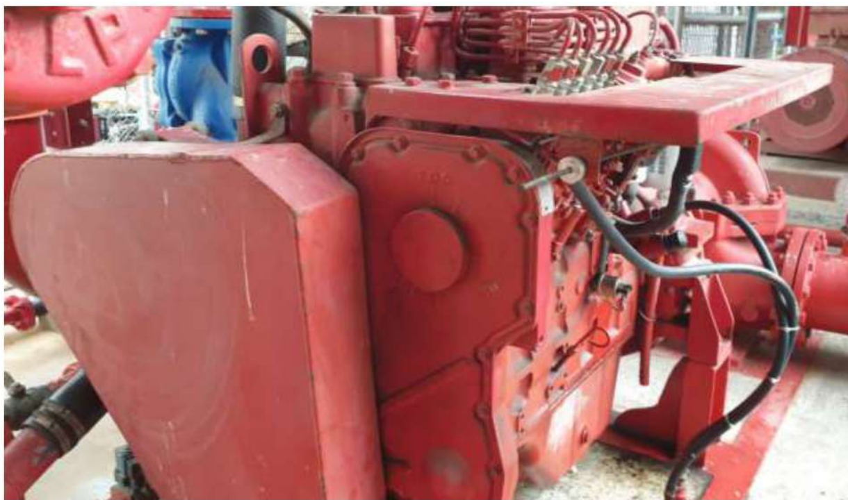
เครื่องสูบน้ำดับเพลิง
