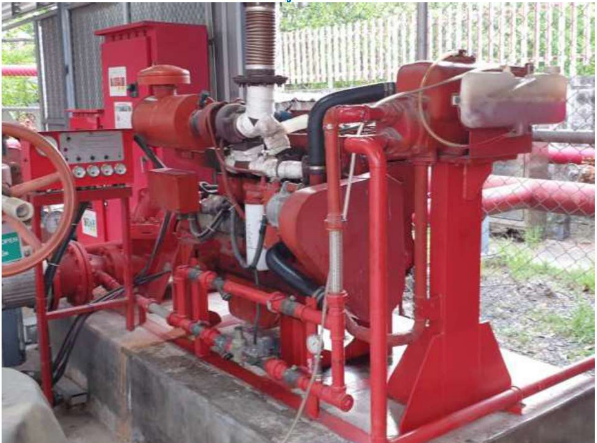
เครื่องสูบน้ำดับเพลิง
