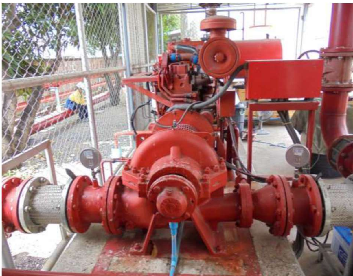
เครื่องสูบน้ำดับเพลิง
