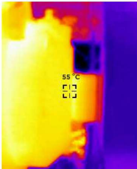
อุณหภูมิเบริงปั้มน้ำ 55 °C
