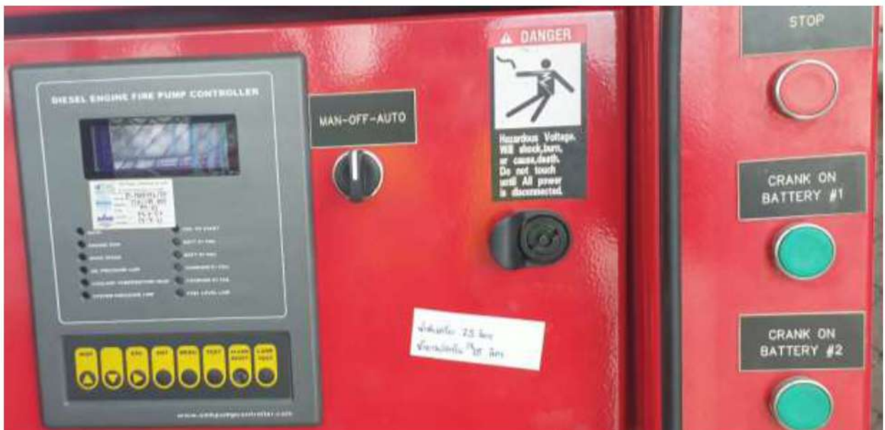
ตู้ควบคุม Fire Pump การเดินสายไฟอยู่ในสภาพปกติ
