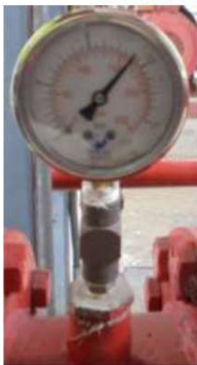
แรงดันน้ำด้านจ่าย=162PSI
