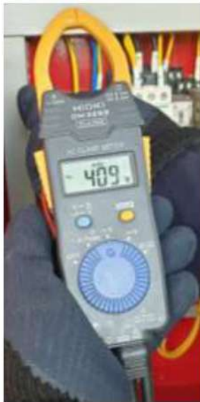
ค่าแรงดันไฟฟ้า R-S
