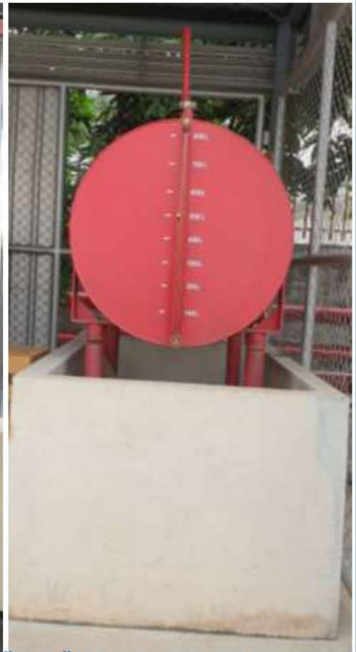
ถังพักน้ำมันเชื้อเพลิง ความจุ 800 ลิตร เขื่อนกั้นน้ำมันความจุ 1,691 ลิตร
